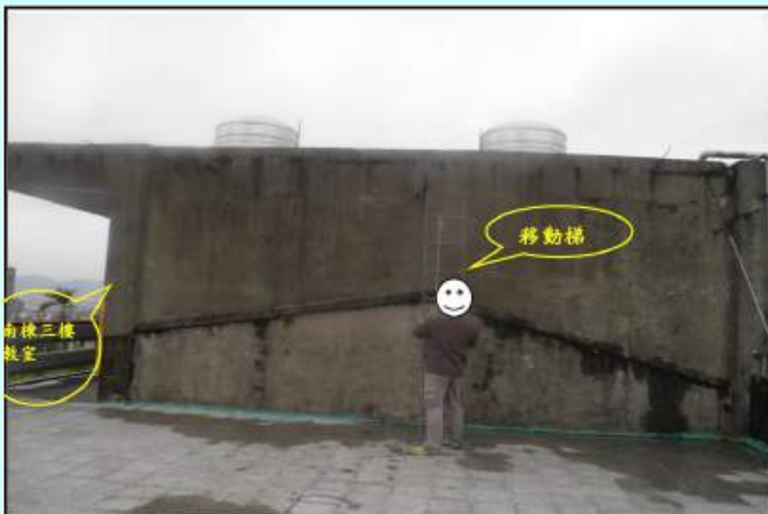
照片 2 | 罹災者使用移動梯由南棟三樓教室外牆爬上三樓教室屋頂
